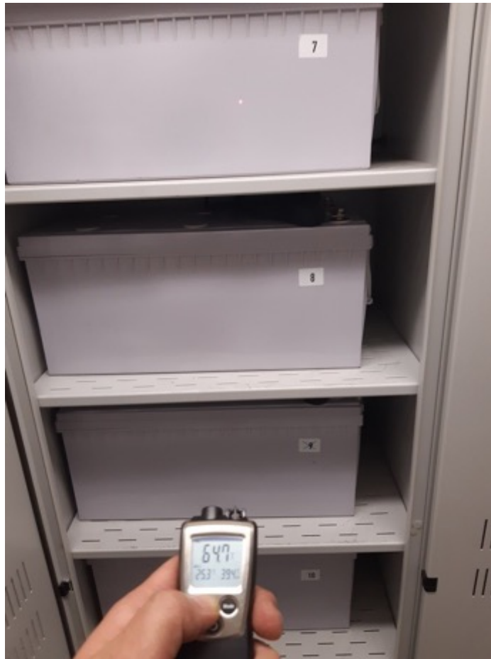
Abb. 5: Manuelle Temperaturmessung an einer Batterie (hier: 64,7 °C)
